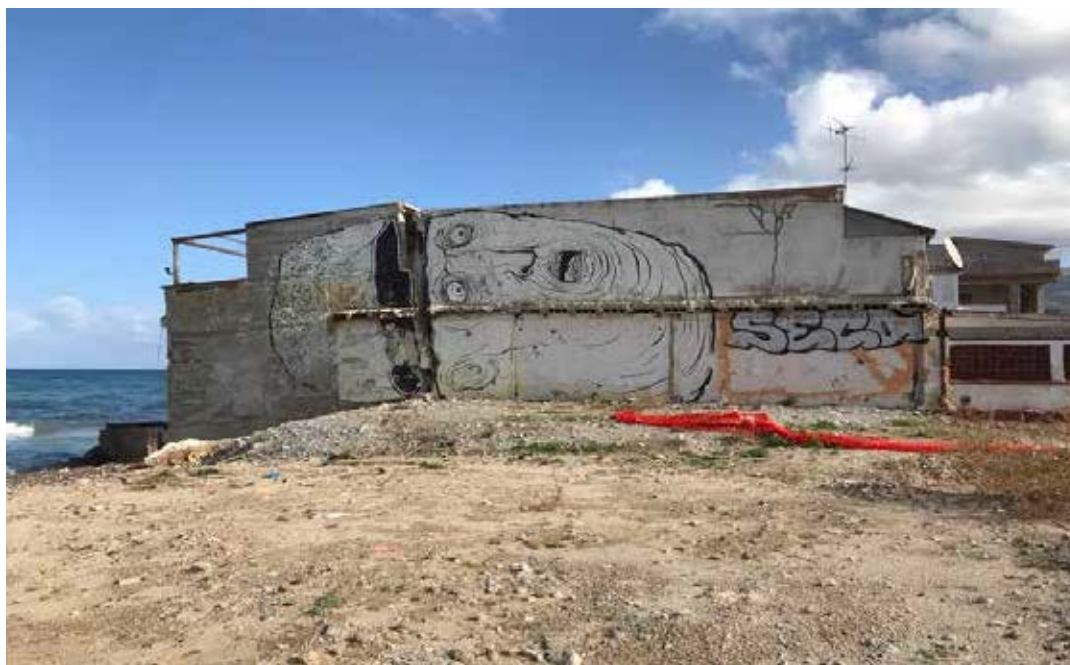
Carini - lungomare - edificio eroso e cadente
